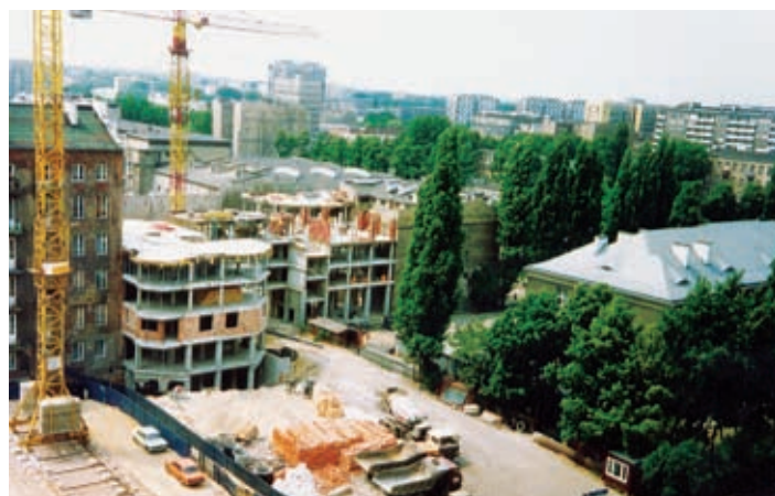
W tym miejscu, w sercu „Dzikiego Zachodu”, pomiędzy ul. Żelazną, a Krochmalną stanęło pierwsze osiedle Dembudu – przez lata niedoścignął wzór nowoczesnej architektury, rewitalizującej zrujnowaną tkankę miasta i obiekt zazdrości wielu osób
